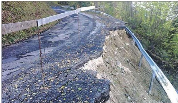
Frana Rischio idrogeologico, è ora di passare ai fatti
